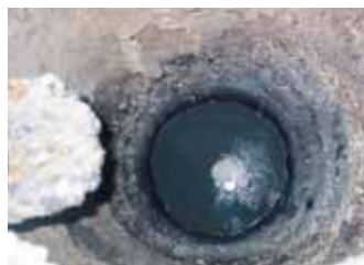
老朽化したマンホール。
